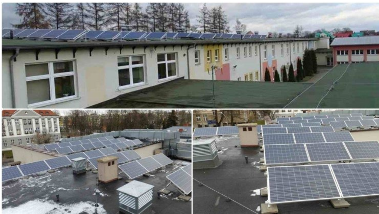
Fot.15. Panele fotowoltaiczne na budynkach Sztumskiego Centrum Kultury i Szkoły Podstawowej nr 1 w Sztumie (źródło: sztum.pl)
