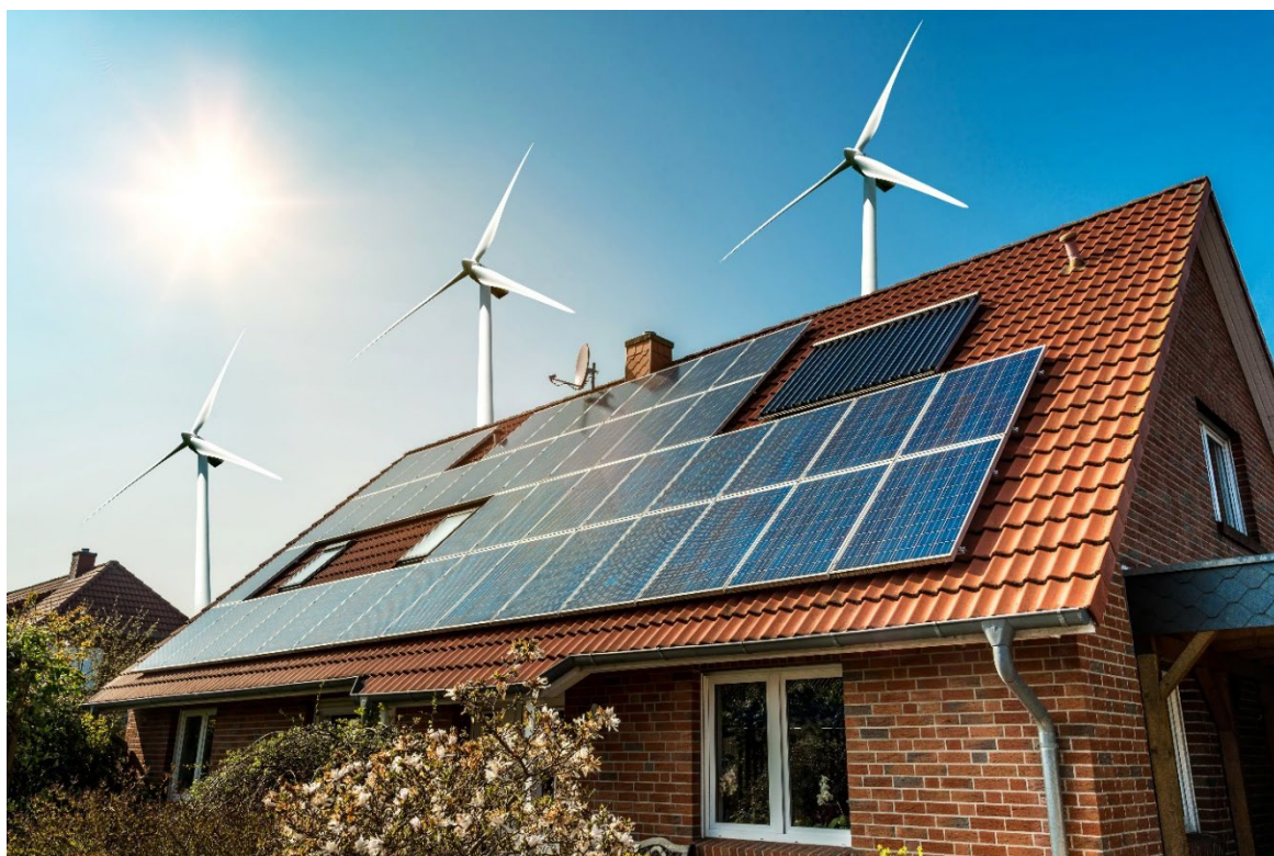
Fot. 7. Instalacja fotowoltaiczna na budynku jednorodzinnym
